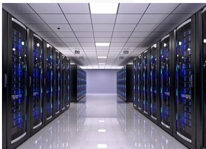
データセンター
